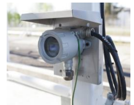
Kaasunvalvontaa Turussa Pansion öljysatamassa.
